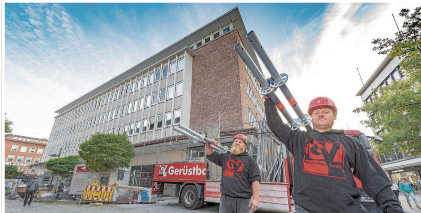
Rüsten das Gebäude in den kommenden Tagen komplett ein: Fritz Friedrichsen (re.) und Gerüstbauer-Kollege Eckard Gurhöfer sind gut in Form.
